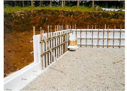
型枠兼用として利用しコストが軽減できる 基礎両面断熱
