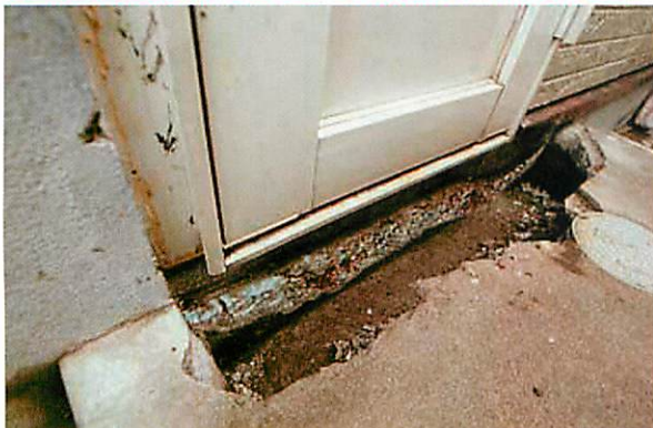
基礎に防蟻対策をしなかった発泡系断熱材の蟻害
