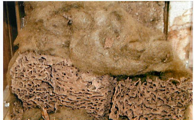
シロアリの巣になった壁内の繊維系断熱材
